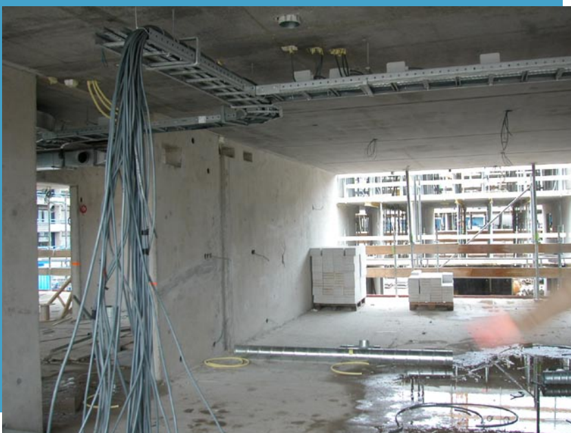
Figuur 16 In het Leo Polakhuis is een enorme hoeveelheid kabels verwerkt voor het domotica systeem
